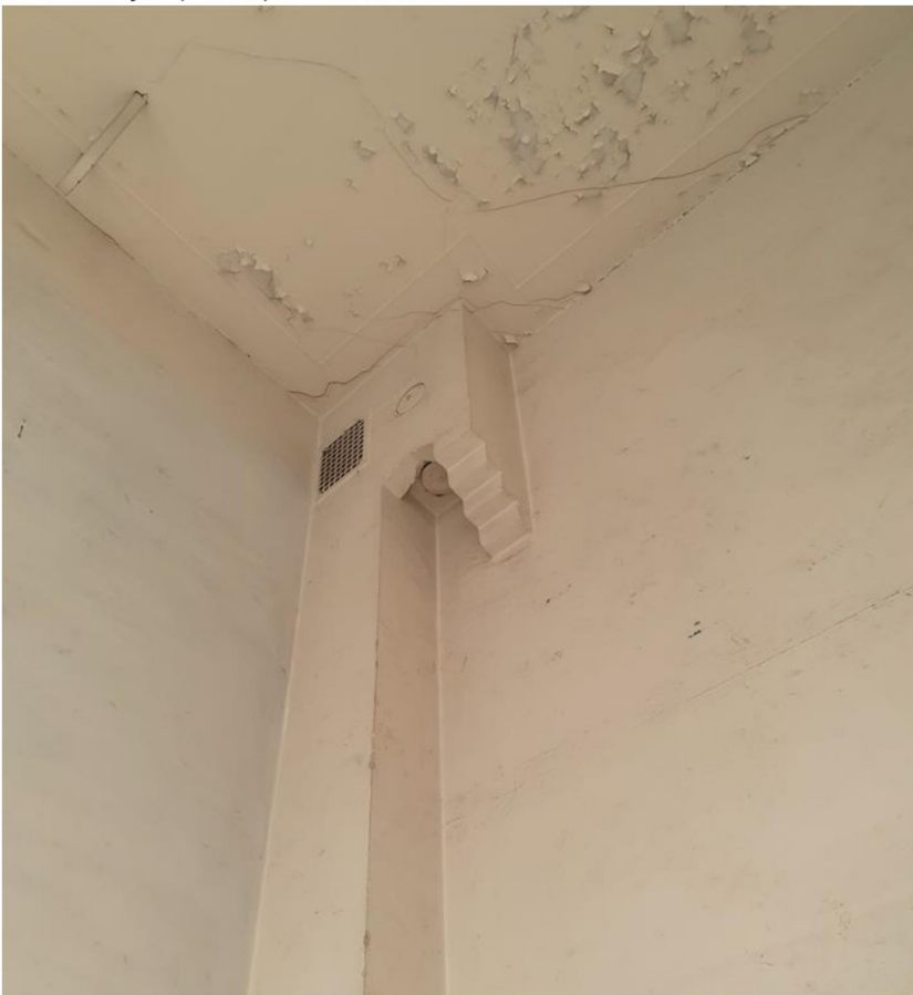
Eén van de rookkanalen voor aansluiting van een kachel in de hoek van een klaslokaal. FH MAB 2023
