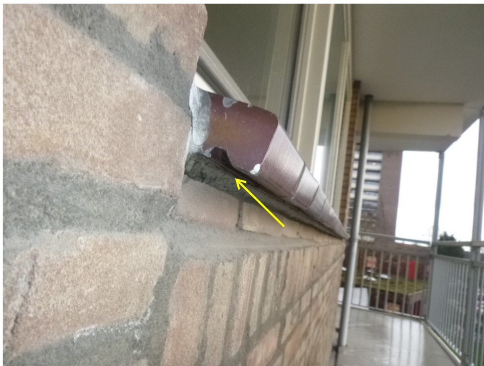
Foto 1: Zicht op bron B01 onder de raamdorpelstenen.
