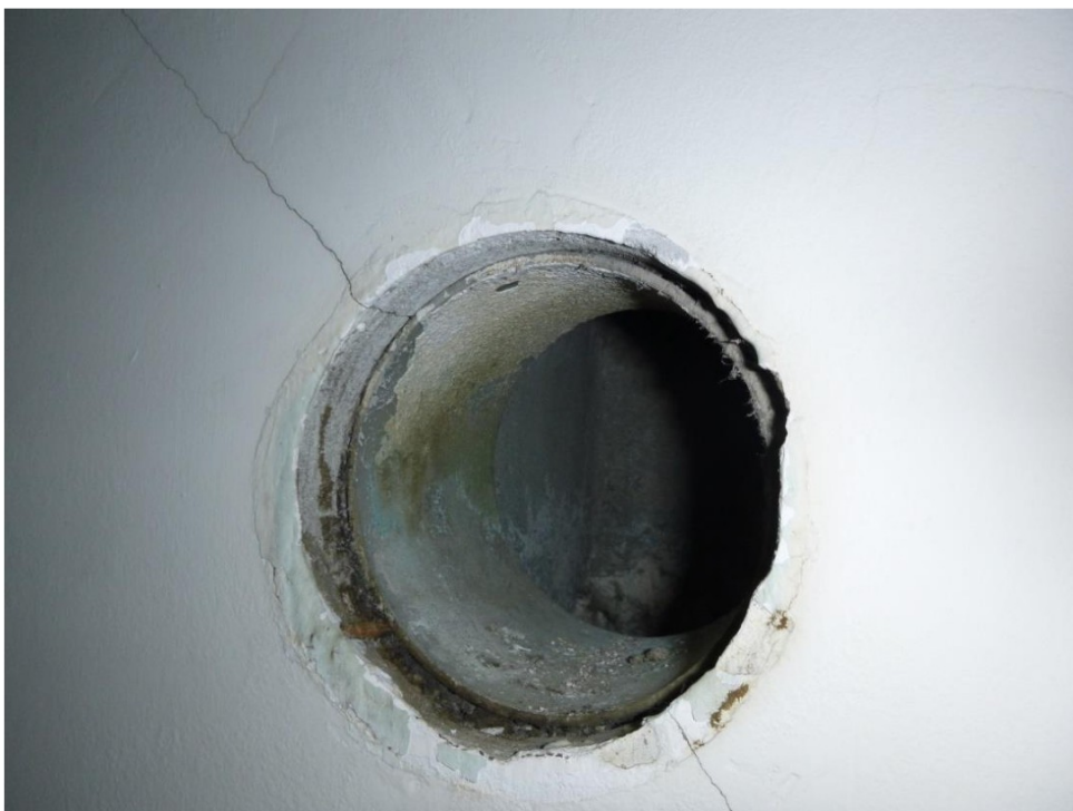
Foto 2: Zicht op een geïnspecteerd ventilatiekanaal.
