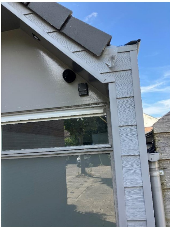
Camera rechts boven bij de deur van het bouwwerk
