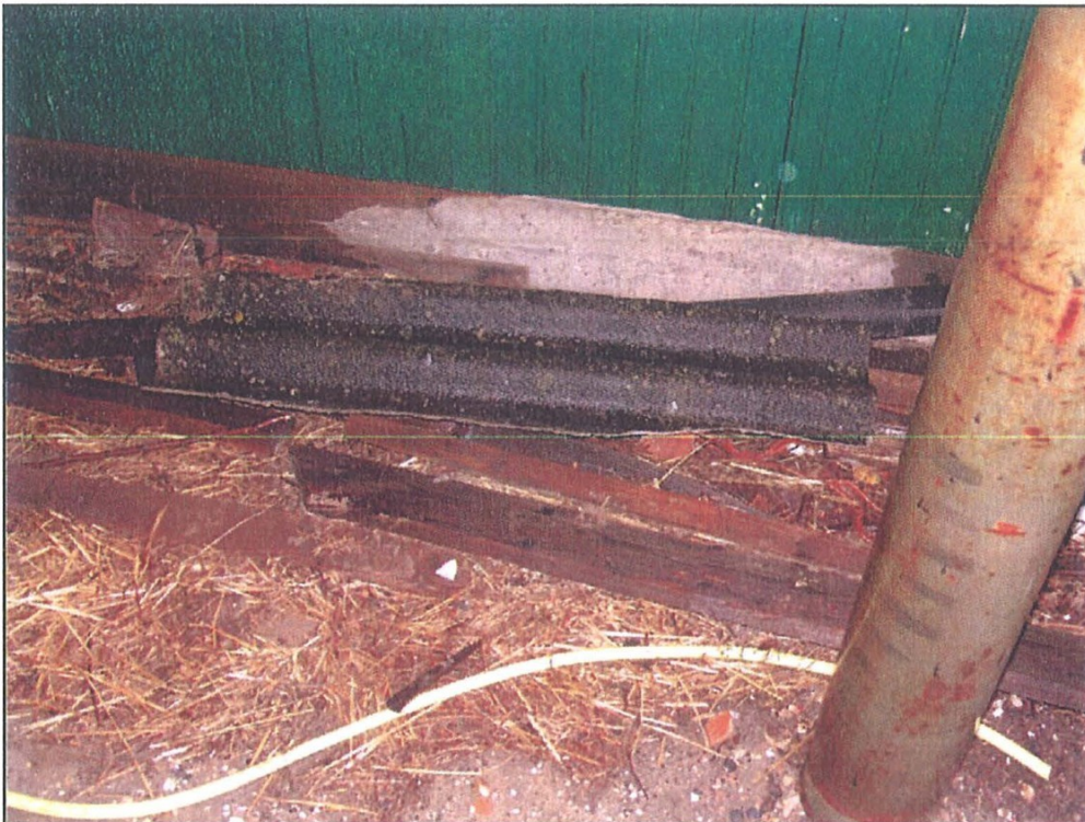
Foto 1: Grote brokken asbest op de grond, in een voormalige schuur
